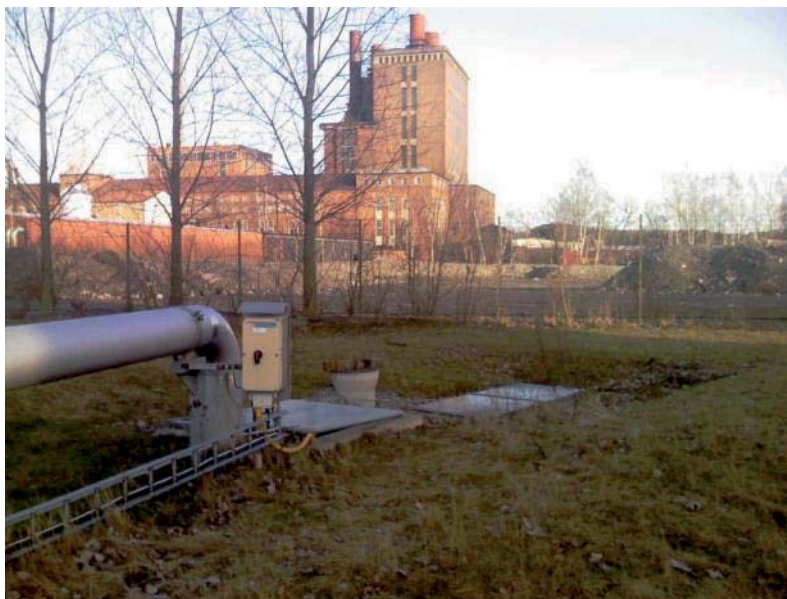
Figur 7 Kylvattenledningens inlopp och pumpgrop till Värmepumpverket
