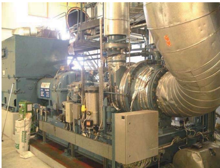
Figur 2 Elmotor och kompressor på Värmepump 2
