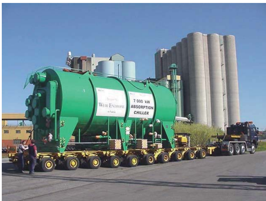
Figur 3 Kylmaskinen vid leverans 2002
