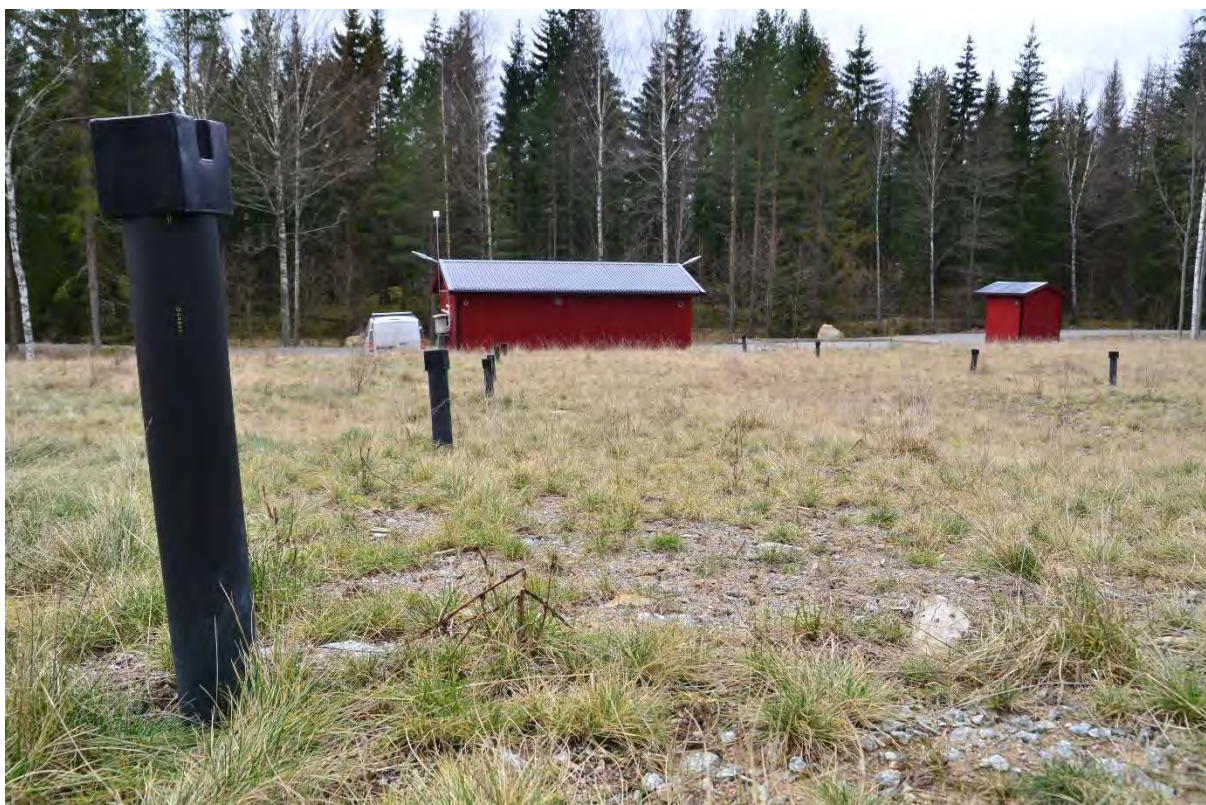
Figur 5. Luftningsrör i markbädd. Foto: Michael Kämpenber.
